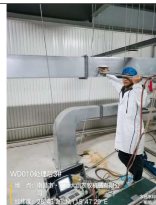
除尘器出口 DW0010 (3#)
