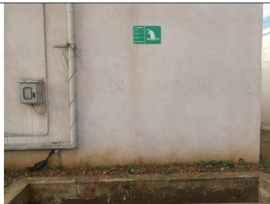
污水处理站排放口
