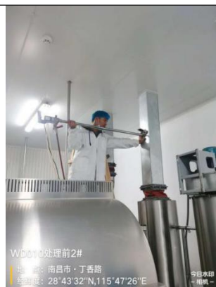
除尘器进口 DW0010 (2#)
