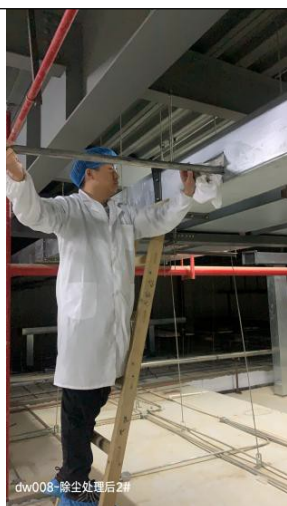
除尘器出口 DW008 (2#)
