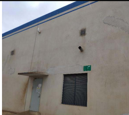
柴油发电机废气排放口
