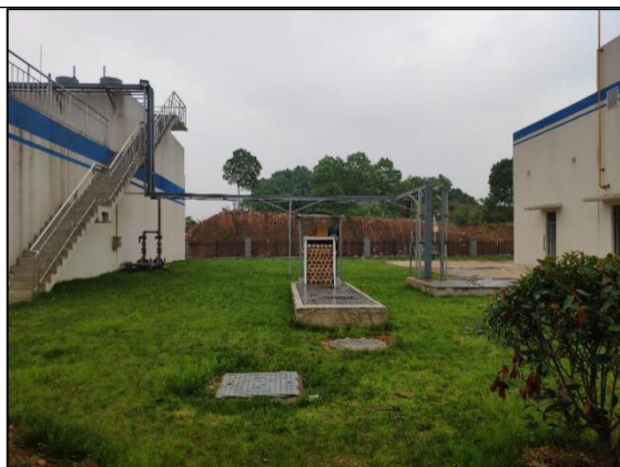
污水处理站格栅井
