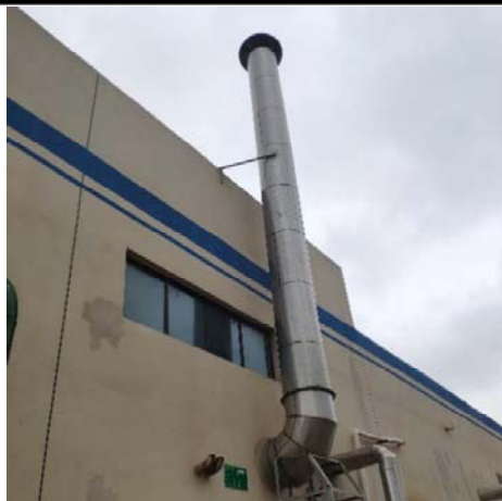
锅炉废气排放口 (12m 高排气筒)
