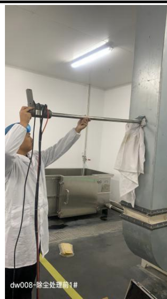
除尘器进口 DW008 (1#)
